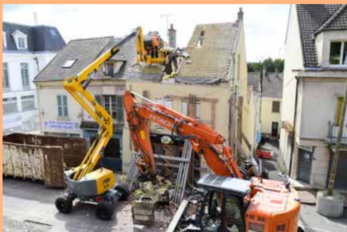
Démolition de la maison en péril qui menaçait de s'écrouler au 177 rue Paul Doumer
